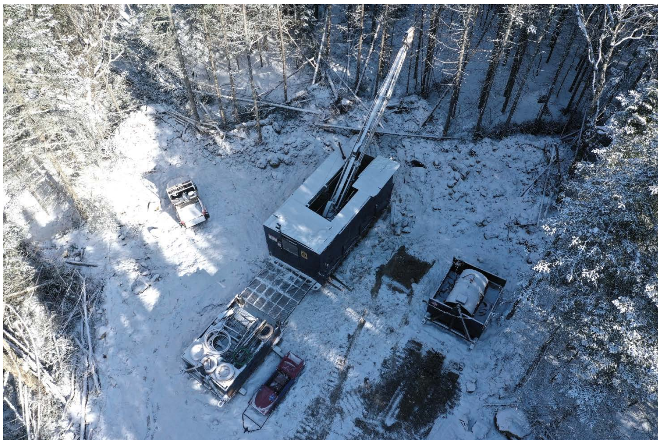
Photo 2 : Petit appareil de forage hydraulique au diamant sur une plate-forme de forage près du lac Kennady.
